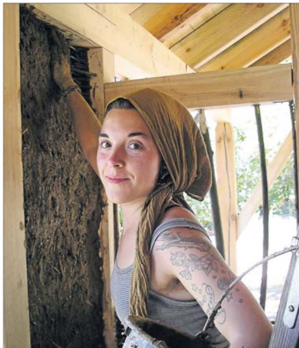
Die traditionellen Techniken des Lehmbaus können die Teilnehmer bei einem Kurs in der Hämmerleinsmühle erlernen. Foto: Kx
